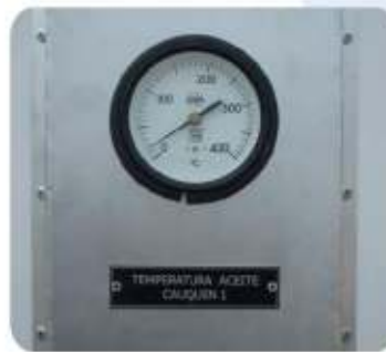
Relojes de control de temperatura, pintura y aceite térmico
